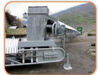
Centrale hydro-électrique de La Bathie 200 m de convoyeurs
